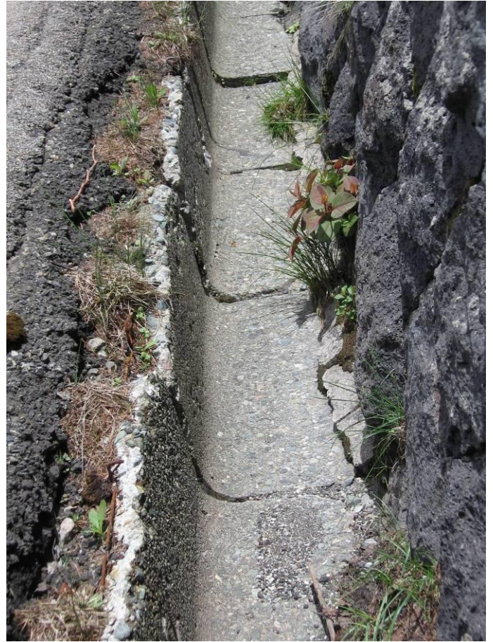
旧設の側溝。劣化が著しい。
