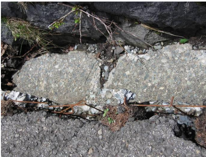
長年による凍害と融雪剤による劣化(拡大)
