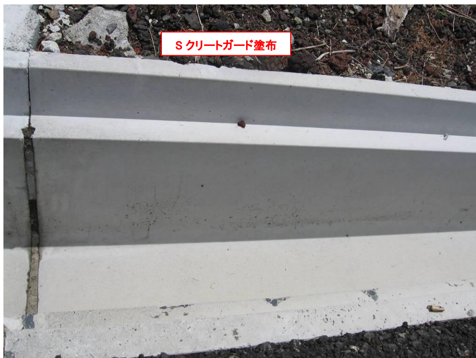
S クリートガード塗布部分。凍害や融雪剤による表面剥離は発生していない。
