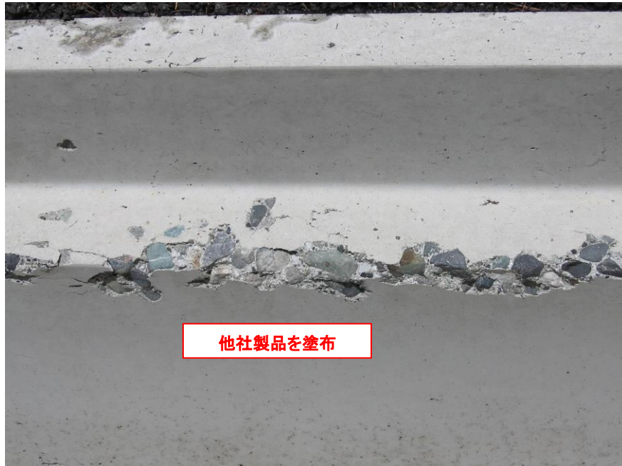
他社製品を塗布した箇所(2年間の自然暴露)。凍害と融雪剤による表面剥離が発生している。
