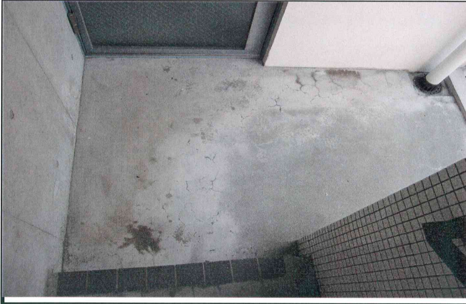
外階段 踊り場 エフロ・汚れ・クラックが目立つ。
